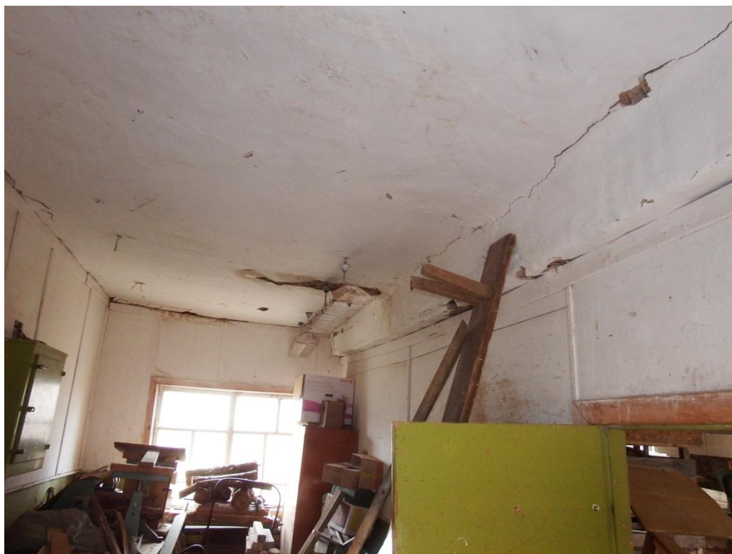
Рис.2.10. Силовые деформации элементов перекрытия, трещины по плоскостям сопряжения со стенами.
