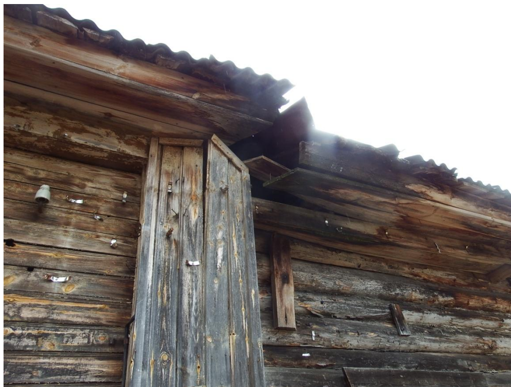
Рис.2.15. Разрушение обшивки, разрушение карниза кровли.
