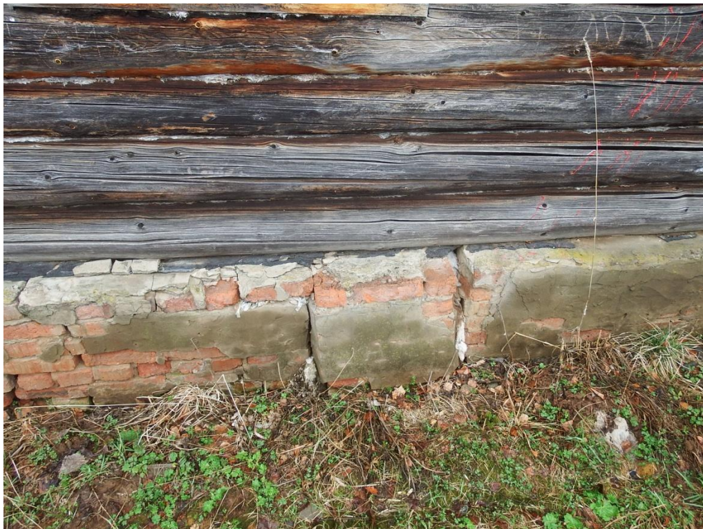
Рис. 2.6. Трещины в фундаменте здания, нарушение монолитности кладки, деградация материала стен, нарушение конопатки межвенцовых швов.
