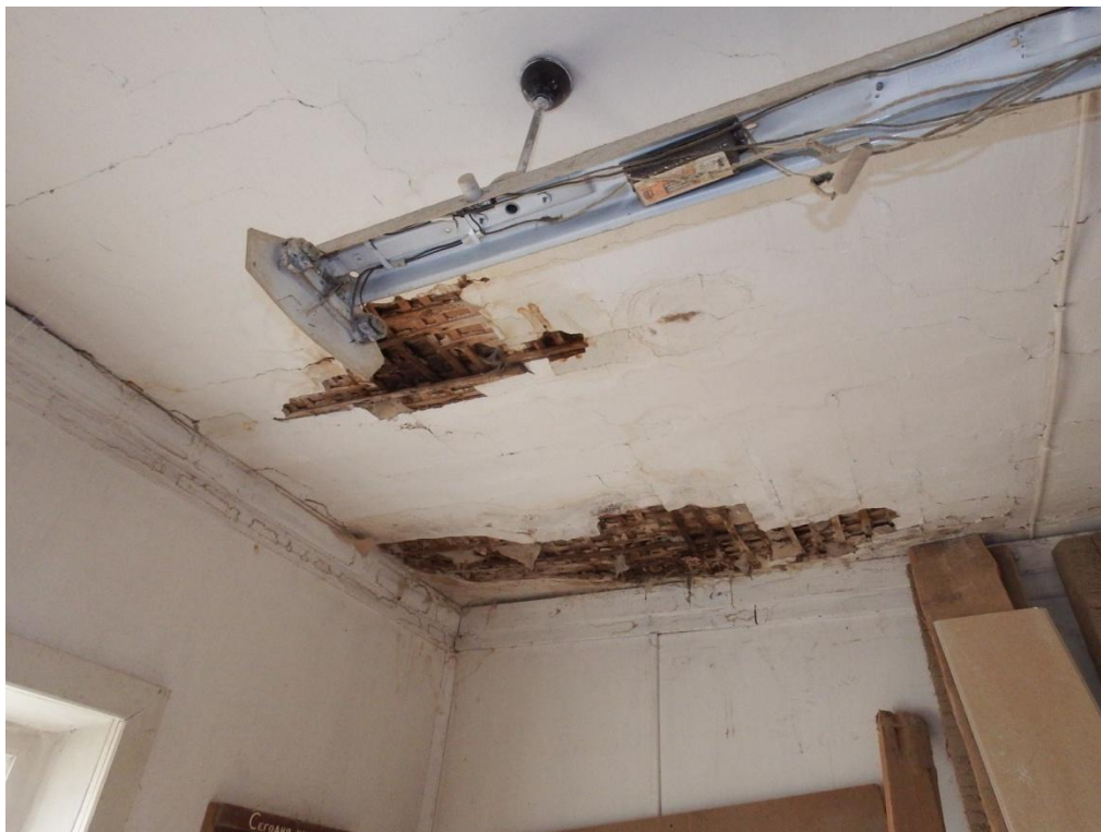
Рис.2.11. Деформация чердачного перекрытия, обрушение штукатурки, трухлявая гниль..
