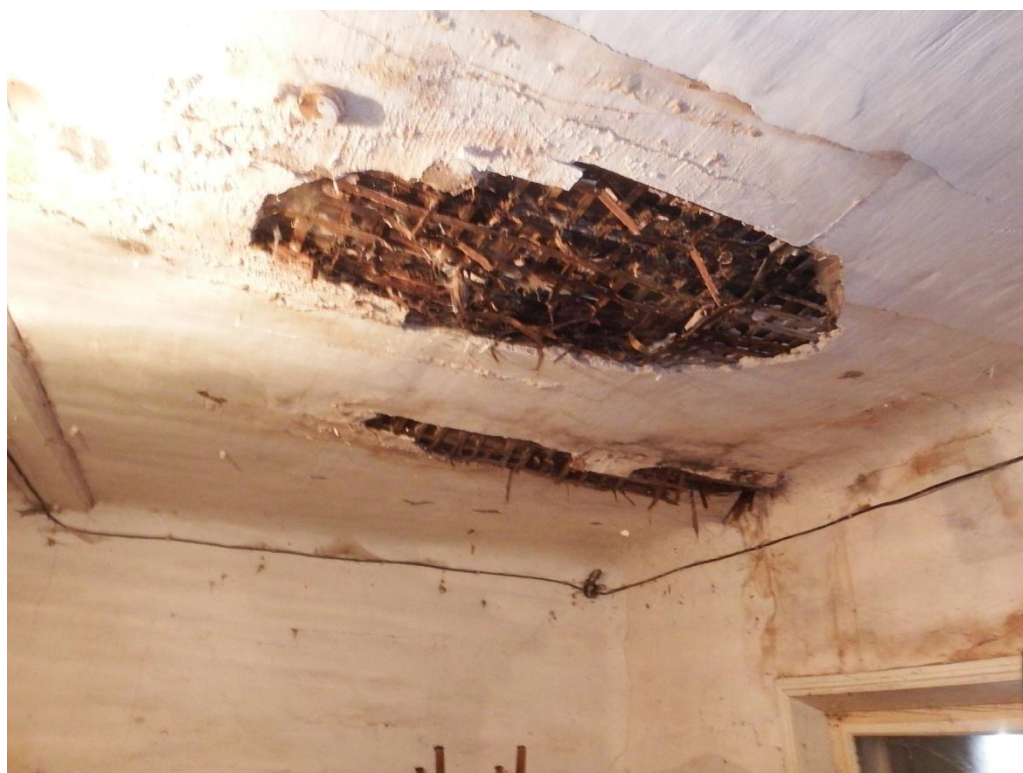
Рис.2.13. Деформация чердачного перекрытия, обрушение штукатурки, трухлявая гниль элементов.
