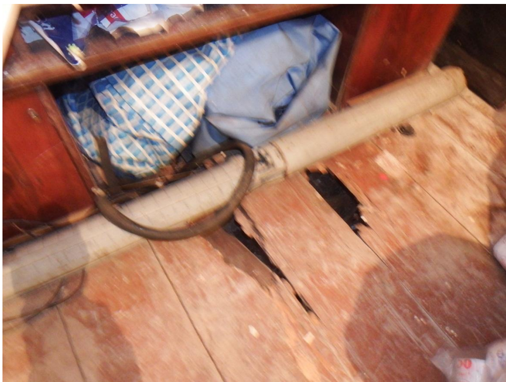
Рис. 2.9. Состояние полов, сквозная трухлявая гниль досок пола.
