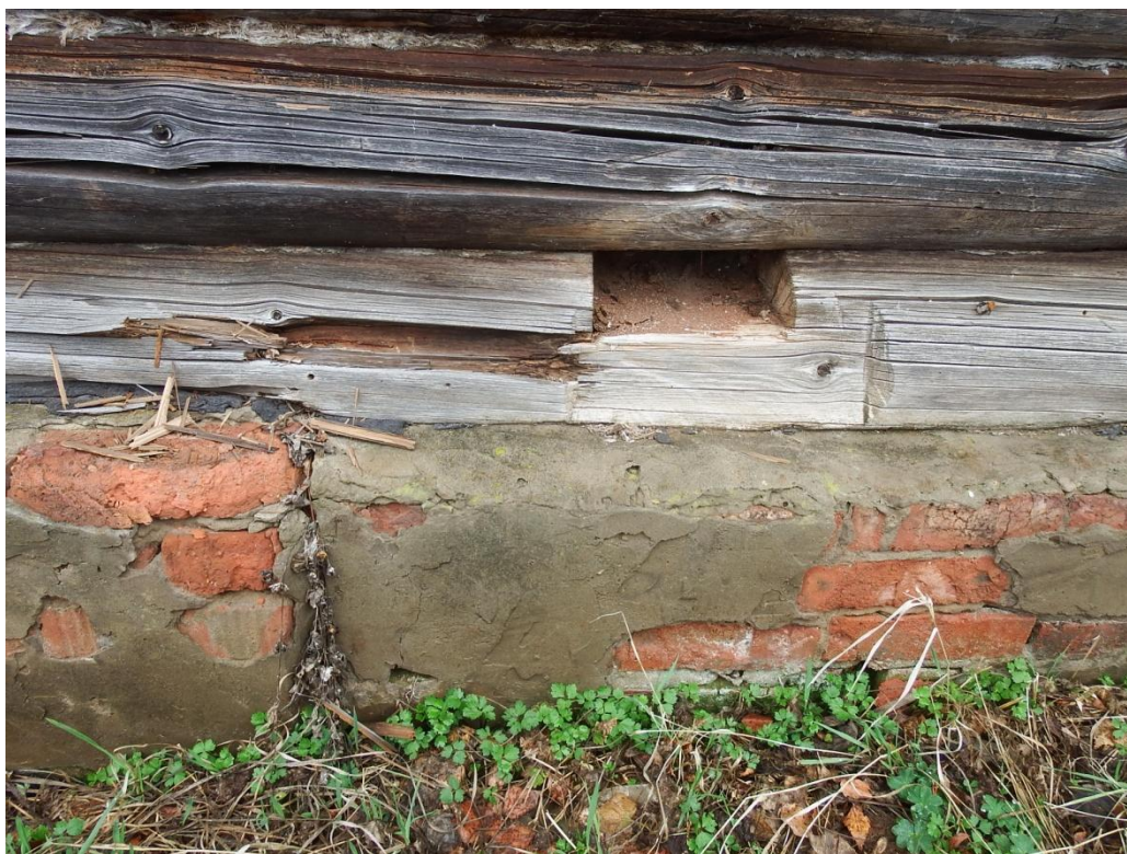
Рис. 2.7. Характерное состояние стен, интенсивное растрескивание , расслоение фундамента, поражение бревен сруба трухлявой гнилью.
