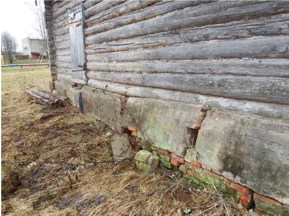
Рис. 2.5. Трещины в фундаменте здания, деформации просадки и разрушение. Биообращание бревен сруба лишайниками. Дegrадация материала стен.
