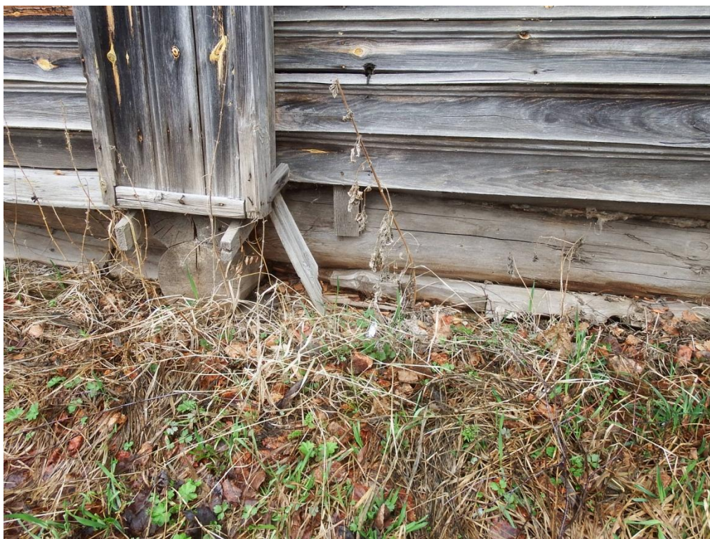
Рис.2.14. Разрушение обшивки, трухлявая гниль закладных бревен сруба.
